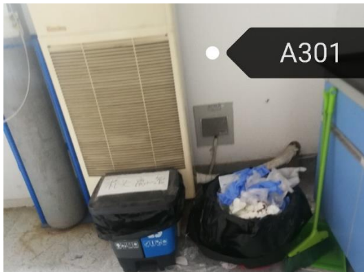
理科楼 A301—实验室废弃物未用黄色垃圾袋
