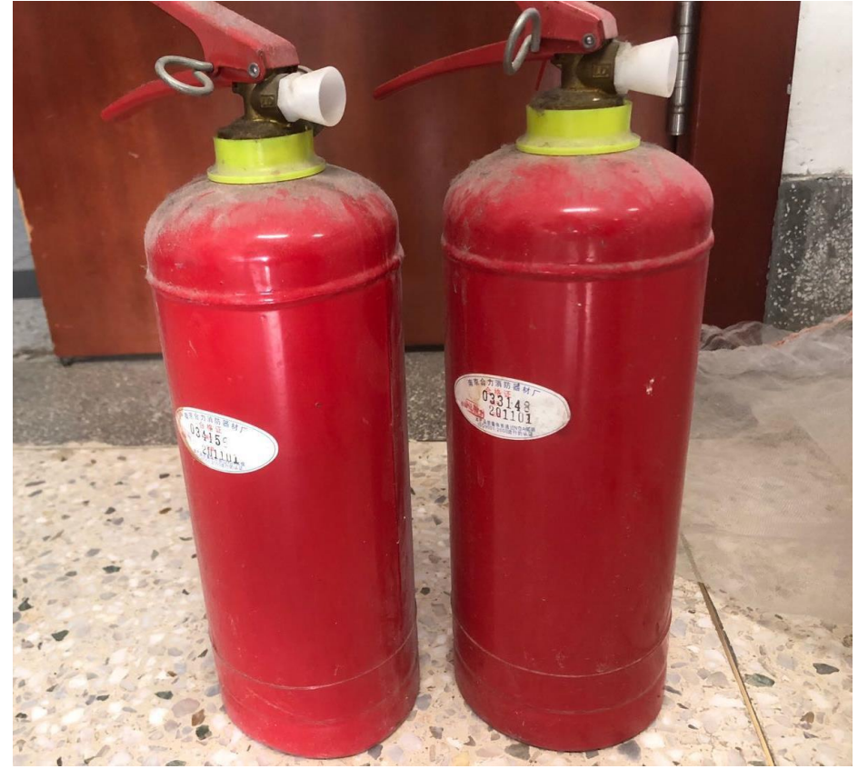
灭火器过期, 且无灭火器架
