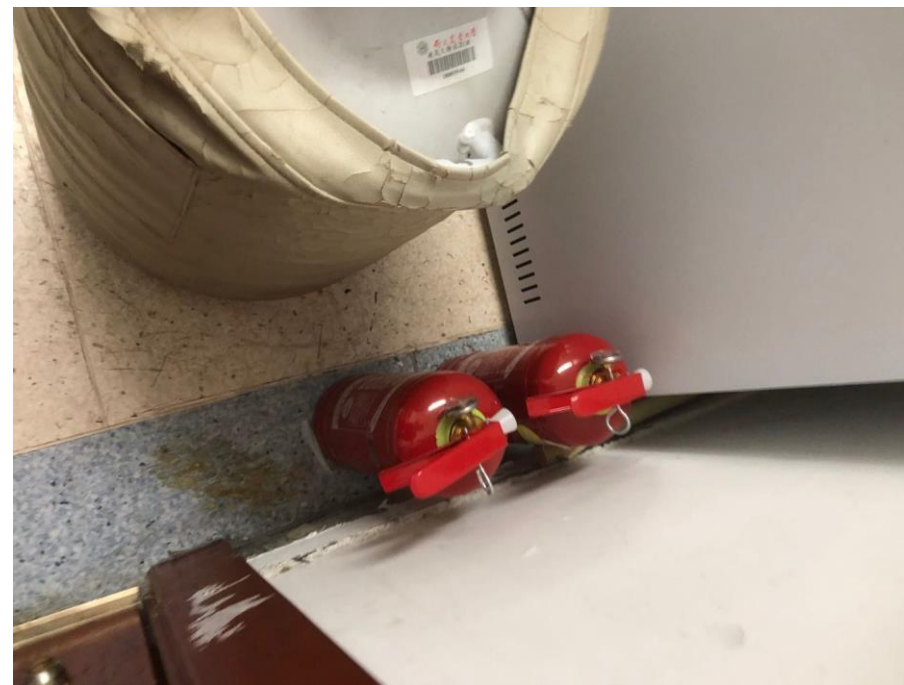
灭火器放置无灭火器架
