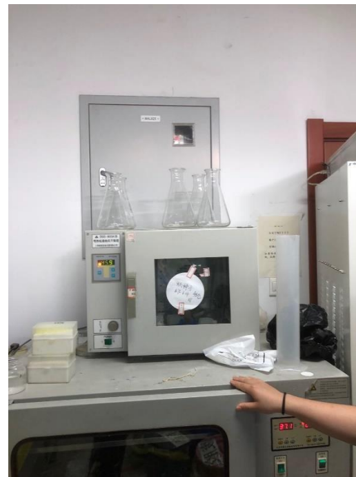
仪器遮挡配电箱, 且放置烘箱上
